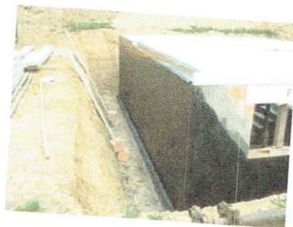
Uszczelnienie zewnętrznej ściany piwnicy z betonu przy zastosowaniu PCI Pecimor® 2K. Wygodna obróbka dzięki wypełnieniu polistyrenowemu.
