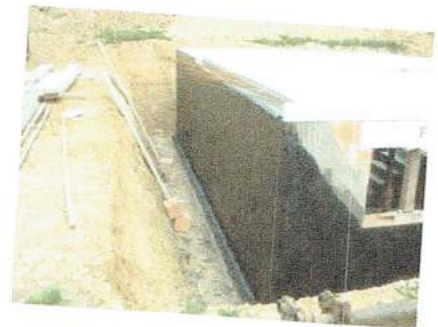
Uszczelnienie zewnętrznej ściany piwnicy z betonu przy zastosowaniu PCI Pecimor® 2K. Wygodna obróbka dzięki wypełnieniu polistyrenowemu.
